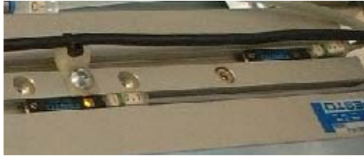
Figura 33: Imagen de los interruptores de proximidad.
