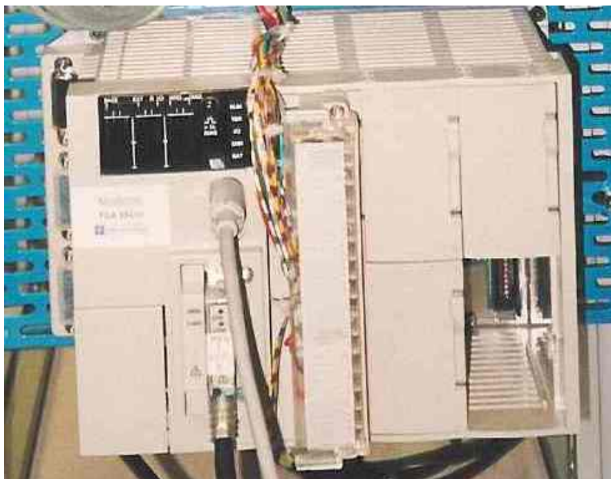
Figura 67: Autómatas TSX 3722, colocado en la estación 3.
