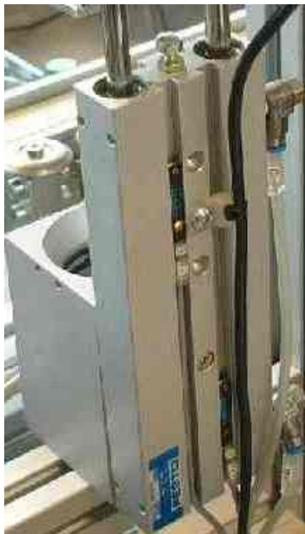
Figura 107: Imagen de los interruptores de proximidad colocados en el verificador.
