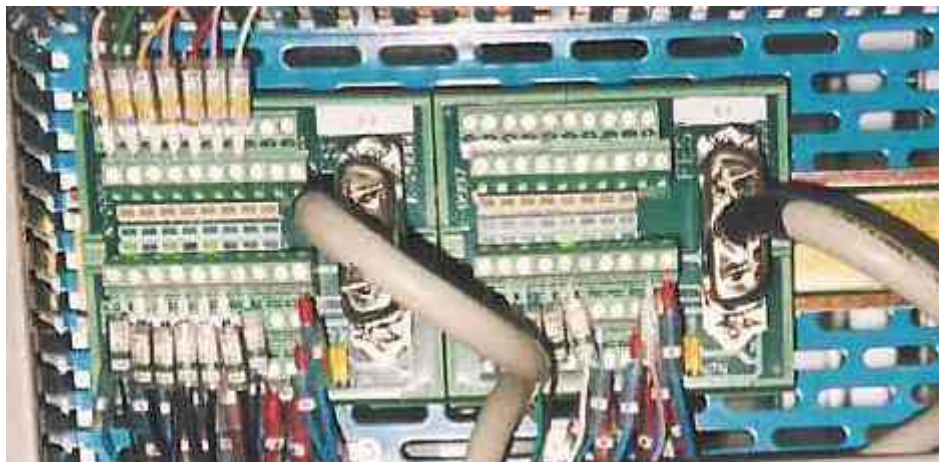
Figura 69: Bases de precableado de entradas / salidas.
