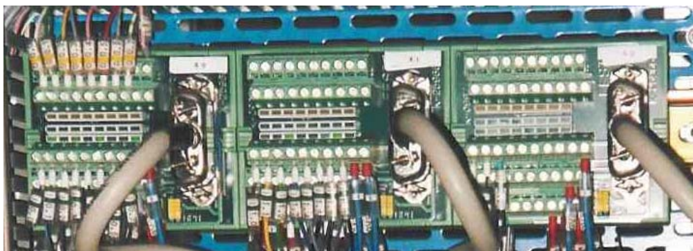
Figura 32: Módulos de precableado de FESTO.
