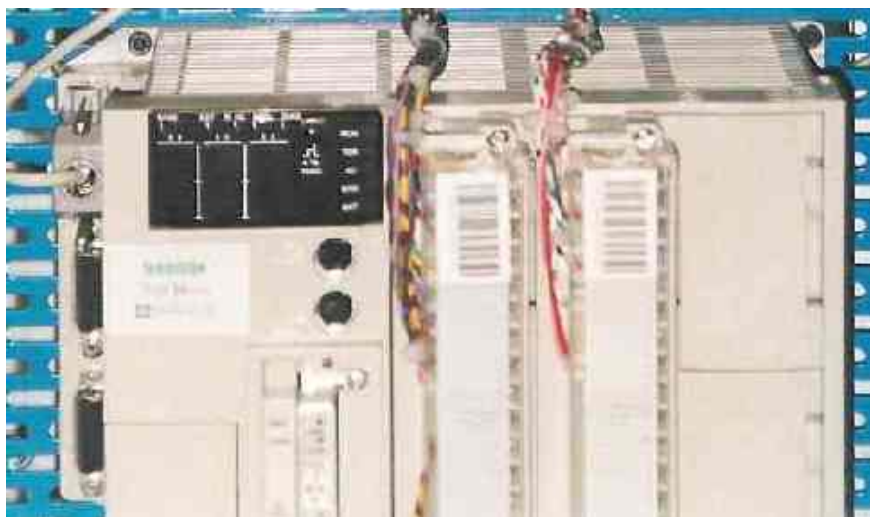
Figura 102: Imagen del autómatas TSX 3722 colocado en la estación 4.
